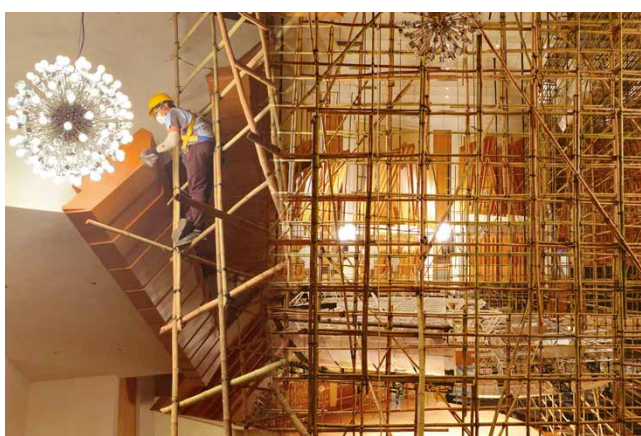
香港文化中心因疫情而關閉，其間音樂廳搭起六層樓高的棚架，進行天花板和回音板的清潔工程。
